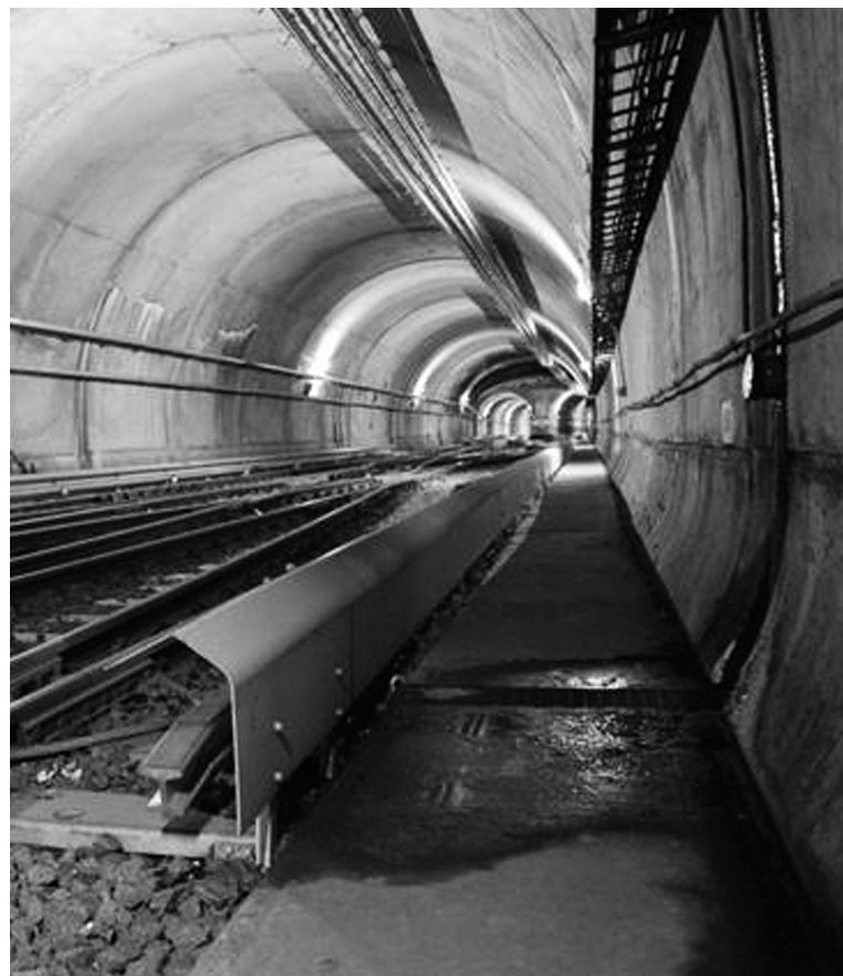
Provocación en el subte. El gobierno de la Ciudad ataca a los metrodelegados que denuncian las gravísimas fallas estructurales que ponen en riesgo a trabajadores y usuarios.
